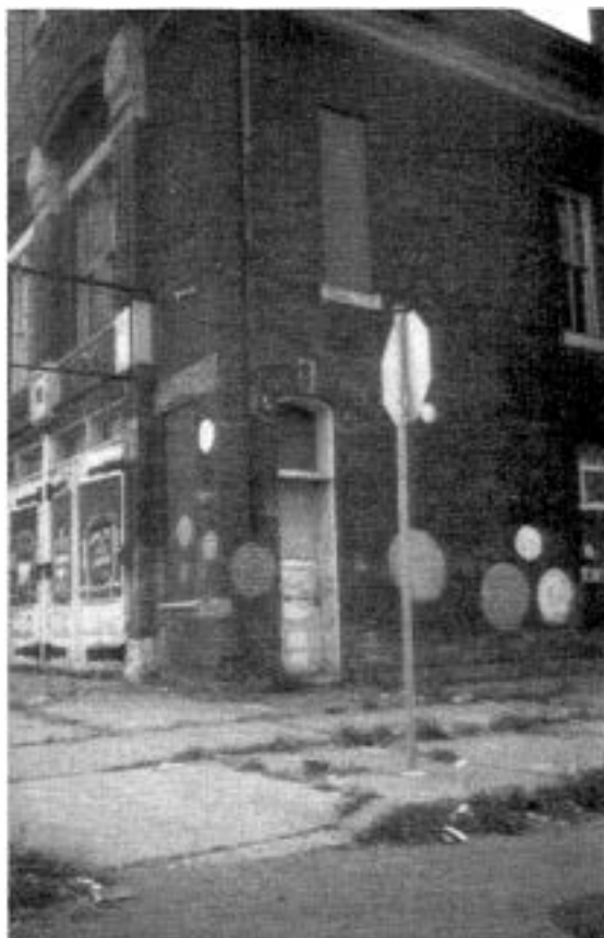
18. Esquina pintada (secuela del «Heidelberg Project»).
